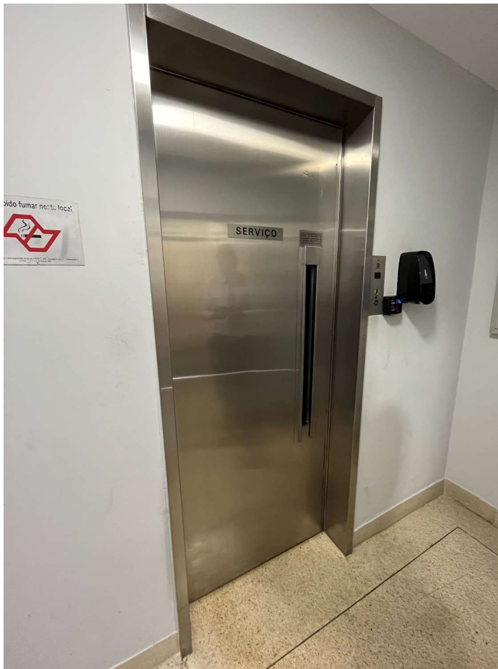
Figura 15: elevador de serviço
